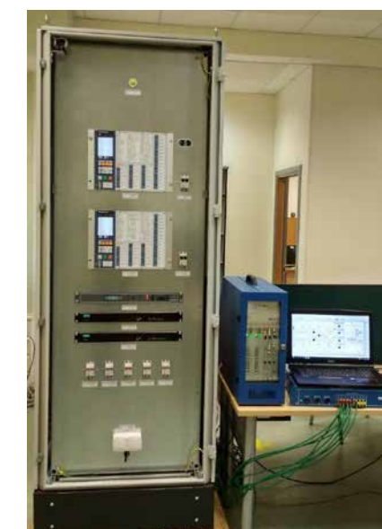
Рис. 2. Шкаф цифровой централизованной защиты с подключением симулятора RTDS
